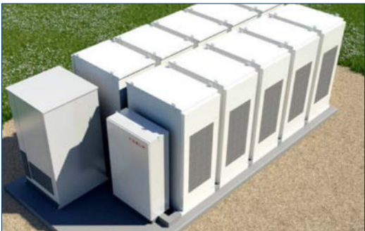
Lithium-ion batteries (2 MW / 2,5 MWh)
