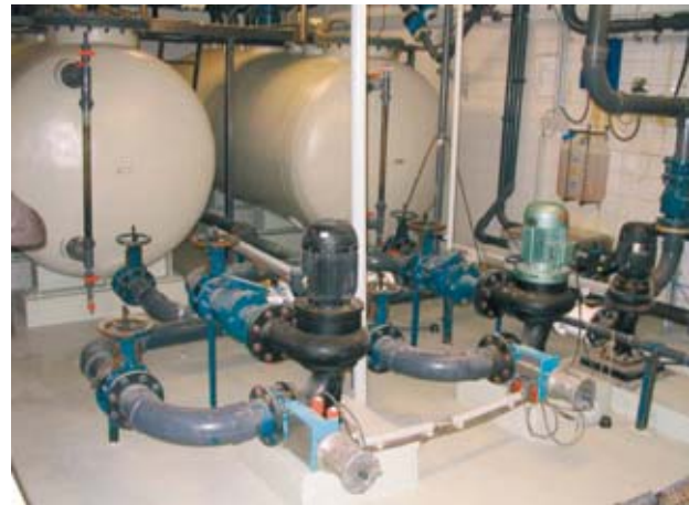
Abwasserbehandlungsanlage im Institut für Veterinärpathologie
