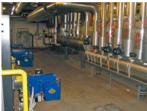
Blick in die modernisierte Nahwärmezentrale mit Heizkesseln und Wärmeverteiler
