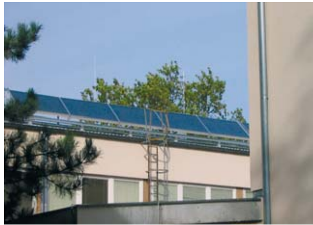
Die erste Solarthermieanlage der FU auf dem Dach des Institutsgebäudes Arnimallee 5-7
