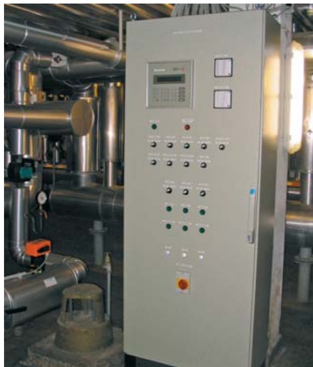
Der Schaltschrank für die Heizungsregelung in der Koserstraße 20
