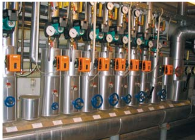
Der modernisierte Heizverteiler im Institutsgebäude Koserstraße 20
