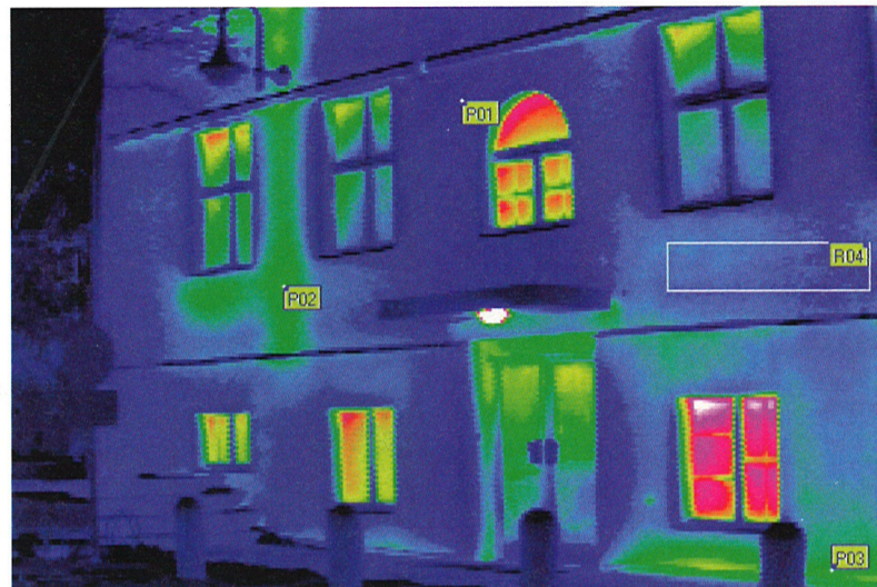
Thermografiefoto vom Eingang des Verwaltungsgebäudes Rudeloffweg 25 – 27, aufgenommen im März 2001 von der Firma Thermophot für das Projektutorium „Ökocontrolling“. Deutlich sind die Wärmeverluste durch die Glasflächen von Türen und Fenstern zu erkennen. Am größten sind sie beim einfach verglasten Fenster rechts unten.
