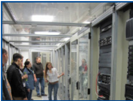
... in den Serverraum...
